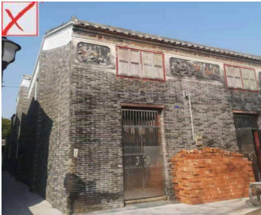
对传统风貌建筑采取盲目“贴瓷片”修缮，属于负面做法
