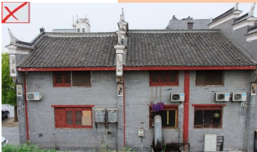
空调室外机无序安装并无美化遮挡，属于负面做法
